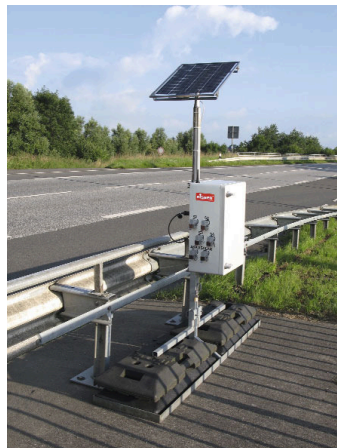
Die Stausensoren überwachen die Verkehrsdichte von Seitenstreifen, Mittelstreifen oder von Brücken aus. Jede Zentralsteuereinheit kann mit Detektoren ausgestattet werden.
